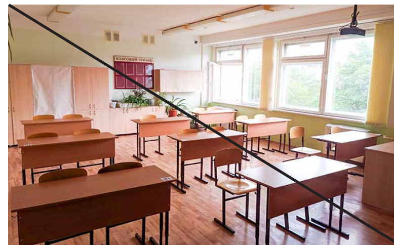
Плохо Линолеум под дерево
